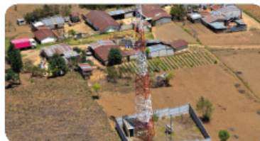
Repetidora Canton Chitux
