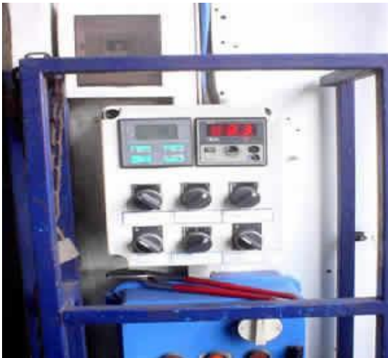
Panel de control de HR y T°C
